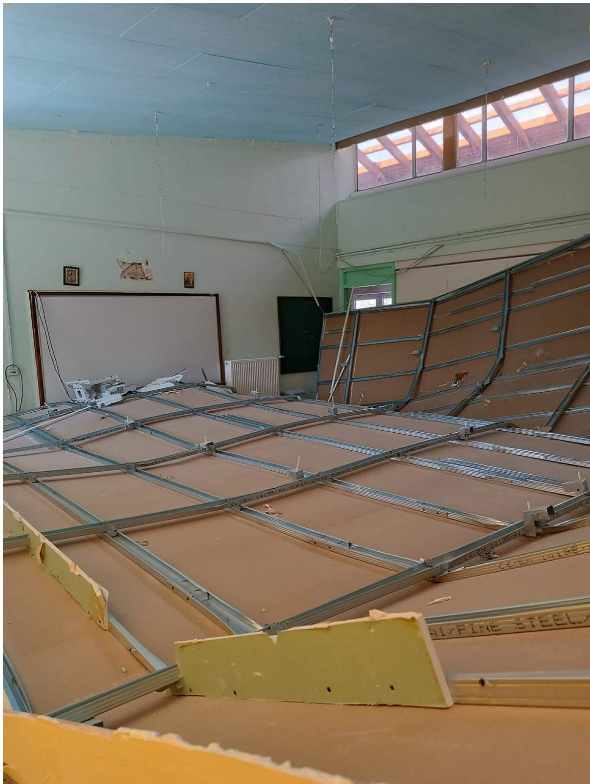
Εικόνες από την κατάρρευση της γύψο – οροφής στο Δημοτικό Σχολείο Βαρνάβα.
